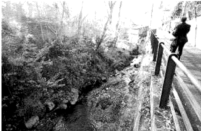
La frana di via Mignone, a San Desiderio, ora messa in sicurezza PAMBIANCHI
