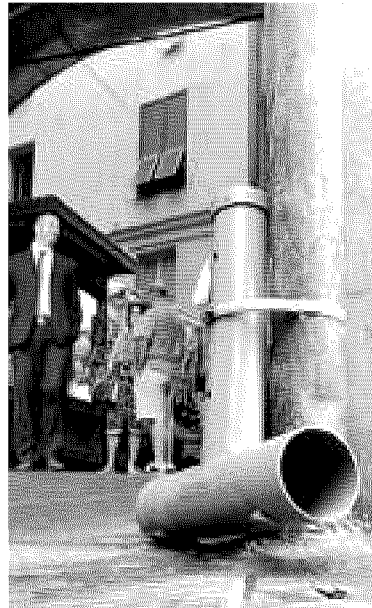
I tubi per la posa delle esche
